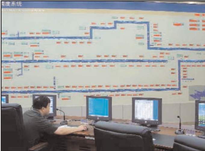
Un operador accede al sistema de inteligencia de planta y control supervisorio del Río Amarillo a través del ambiente integrado de desarrollo del Industrial Application Server.
