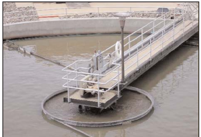
Piscina de Aireación
