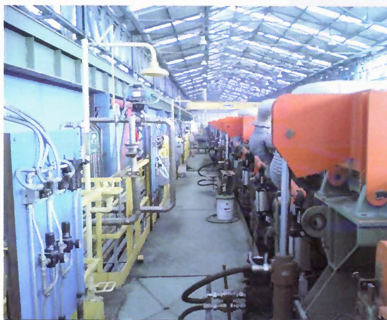
FIG|06 Un dettaglio della linea: la sezione delle vasche di decapaggio.
