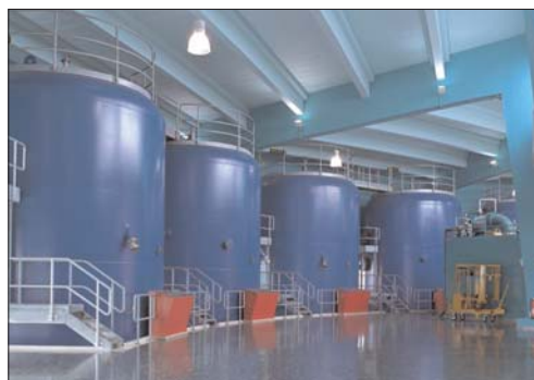
Filterhalle im Wasserwerk „Am Staad“
