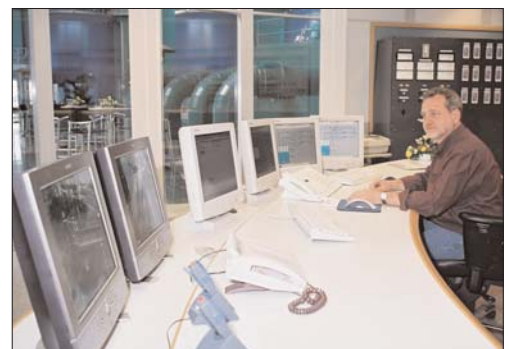
Leitwarte im Wasserwerk „Am Staad“
